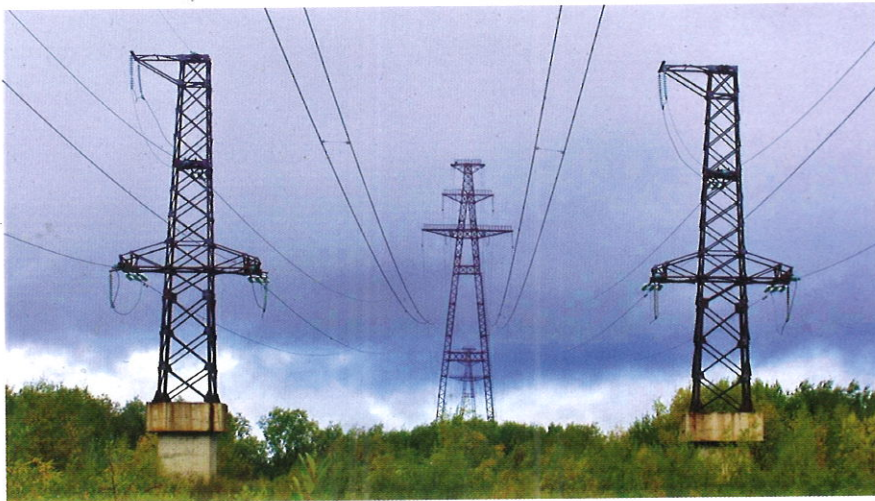
Рис. 8. Вид на левобережную часть в створе специального перехода: концевые опоры проводов (под каждую цепь) и две промежуточные «качающиеся» опоры СПК-83, поддерживаемые грозозащитными тросами АСУС-300 (фото автора, июль 2007)
