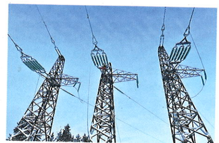
Рис. 12. Стойки концевой опоры на правом берегу специального перехода ВЛ 220 кВ через р. Печора с выполненной подвеской проводов и тросов, идут монтажные работы по шлейфам (12.2021)
