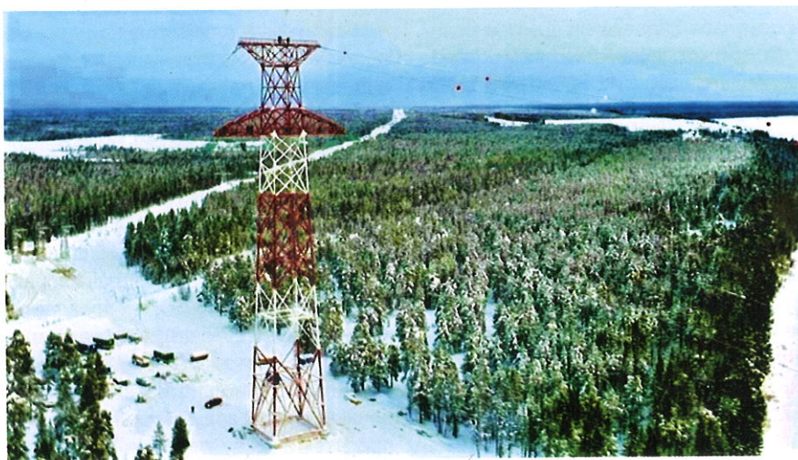
Рис. 10. Вид на правобережную часть специального перехода ВЛ 220 кВ через Печору перед включением, грозозащитные тросы оборудованы маркерами (12.2021)
